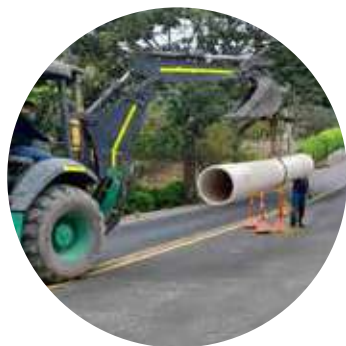
Sistema de acueducto
