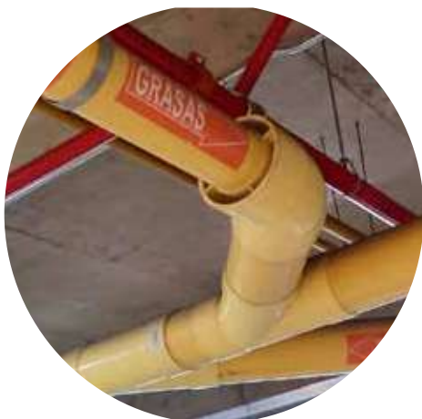
Sistema en PVC sanitario y ventilación
