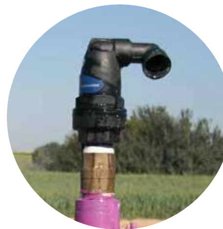
Válvulas de aire ventosas
