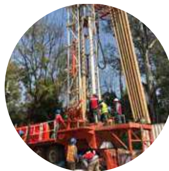
Sistema pozo profundo
