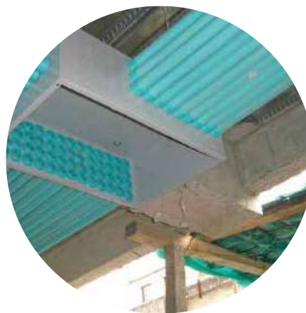
Sistema eléctrico conduit PVC
